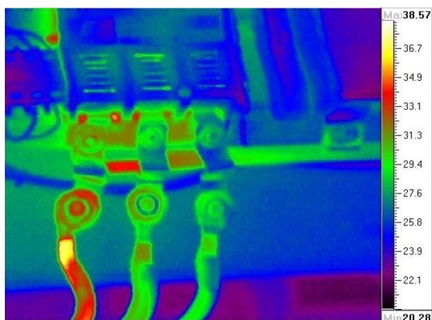
Рисунок 21. Пример термограммы контактных соединений с температурной шкалой
